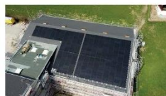
Schulanlage Zimetlach, Rönzstberg; Aufdach-Anlage
